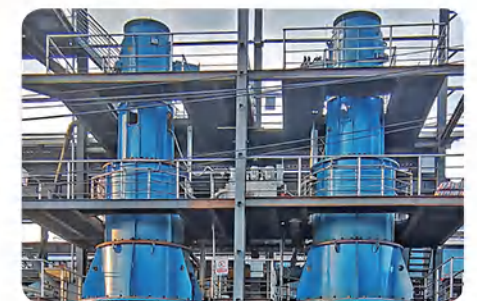
1250kW 立磨机 1250kW vertical grinding mill
