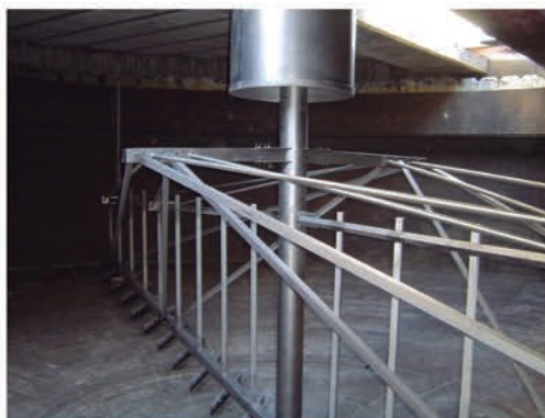
TRATAMIENTO DE LODOS
