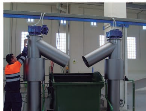
STATIONS DE POMPAGE
