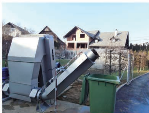
ESTACIONES DE BOMBEO
