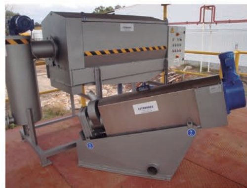
TRAITEMENT DES BOUES
