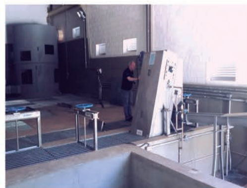
PLANTES DE TRAITEMENT DES EAUX USÉES
