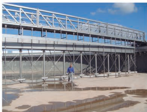
DEPURADORAS DE AGUAS RESIDUALES
